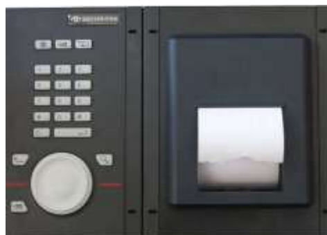
Рис. 2. Принтер протокола В5-MIC-PPE, установленный возле панели В5-MIC711
